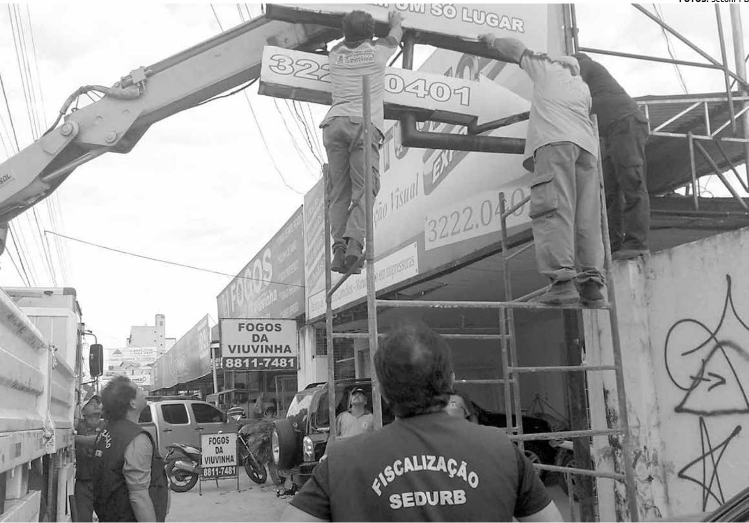
Sedurb iniciou a remoção dos materiais que estavam ocupando o passeio público, o que é proibido pelo Códio de Posturas do Município
