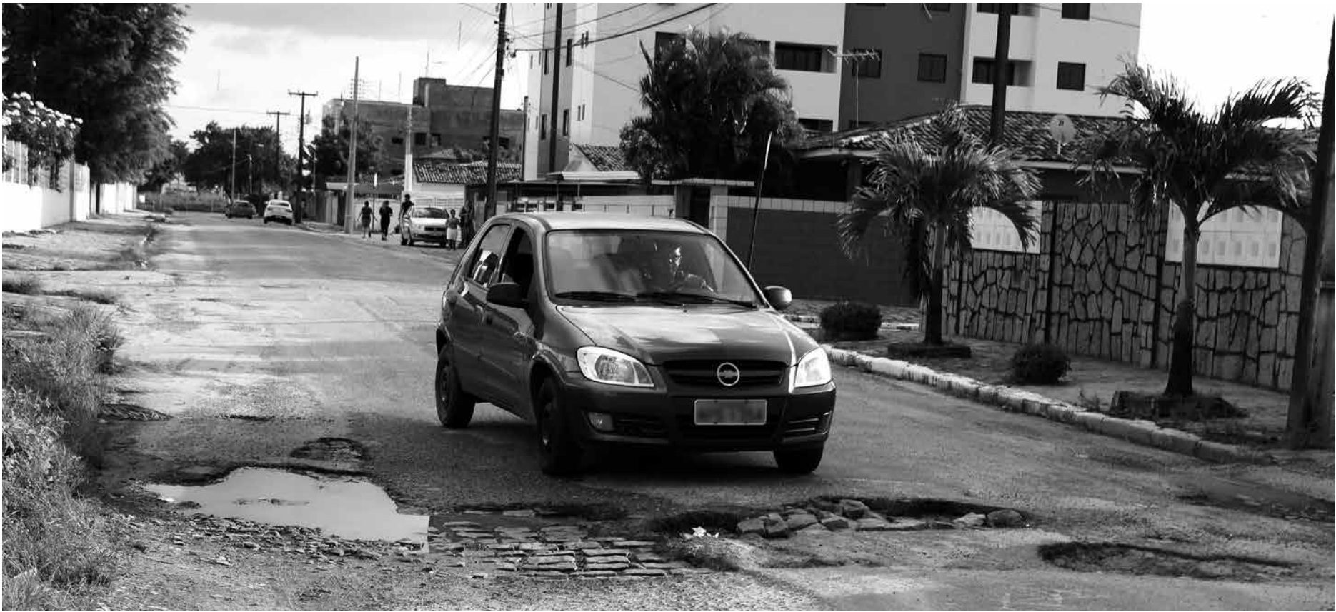
Moradores e motoristas que trafegam pela Rua Hilton Guedes Pereira, no Cristo Redentor, reclamam que os buracos existem há mais de seis meses no local
