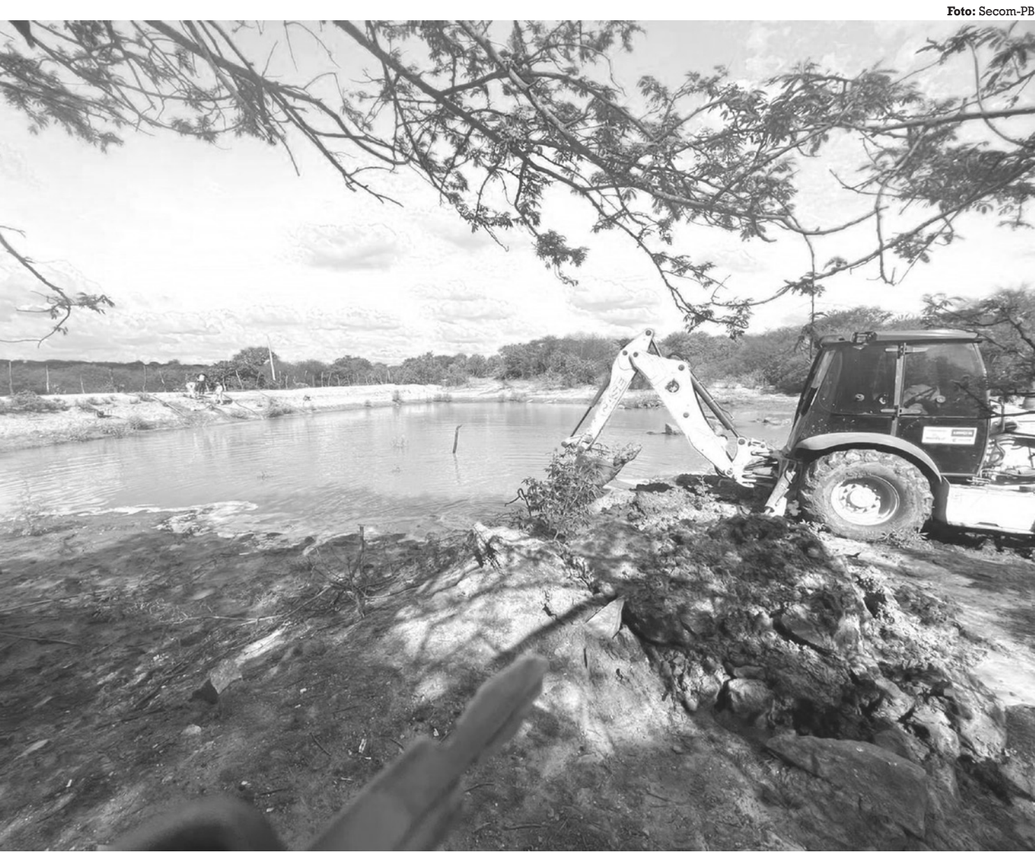
Foram 36h de serviço contínuo para corrigir a falha que provocou a vazão de água. Problema prejudicou abastecimento em locais do Sertão
