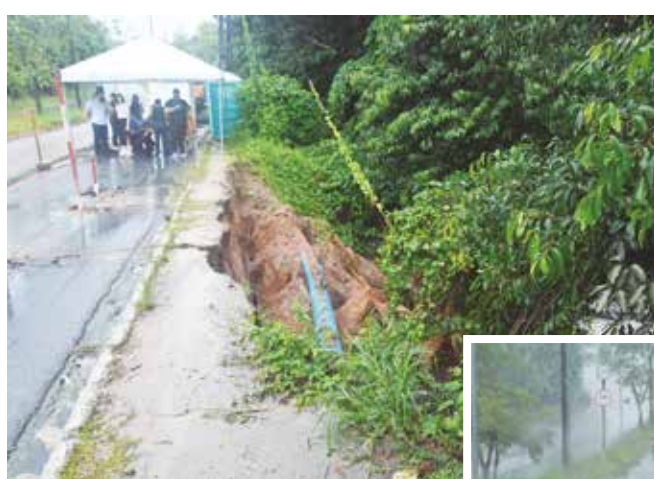
Buraco às margens da via surgiu após deslocamento de terra e de manilha de concreto; trecho está interditado no sentido Centro-bairro
