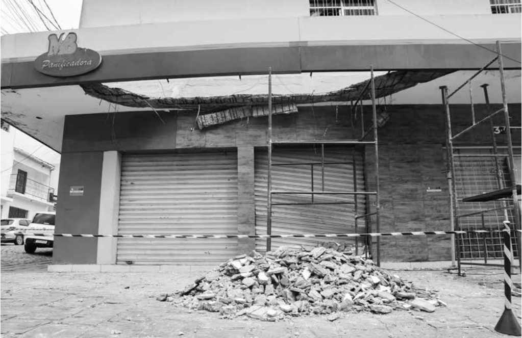
Proprietário comprometeu-se a demolir toda a estrutura para evitar novos acidentes
