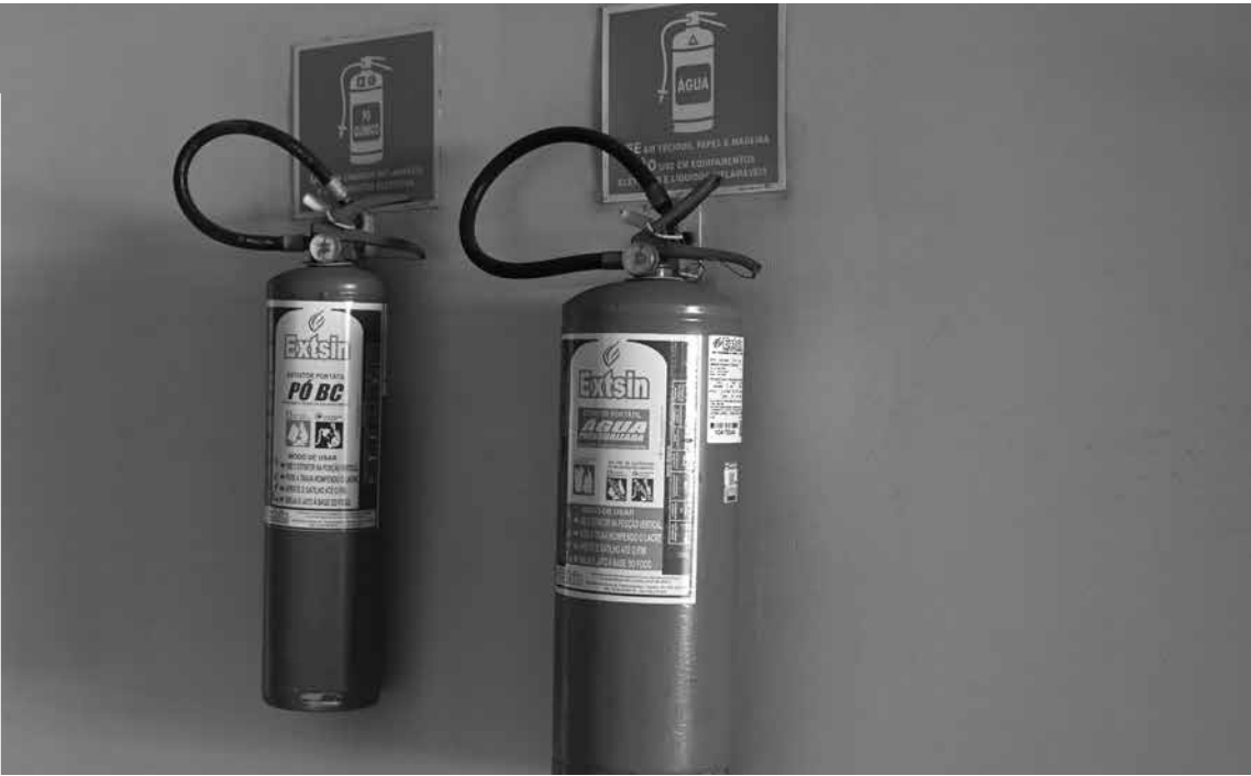
Extintores estão entre os dispositivos que podem ser exigidos para o funcionamento de espaços comerciais
