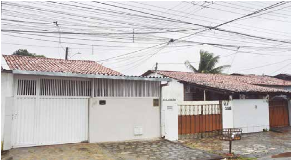
Emaranhado dificulta identificação correta dos fios; já os cabos soltos ameaçam segurança
