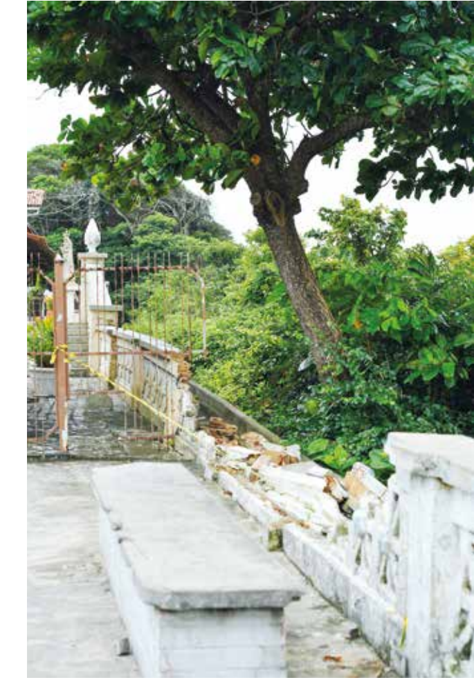
Defesa Civil instalou uma faixa de isolamento no local
