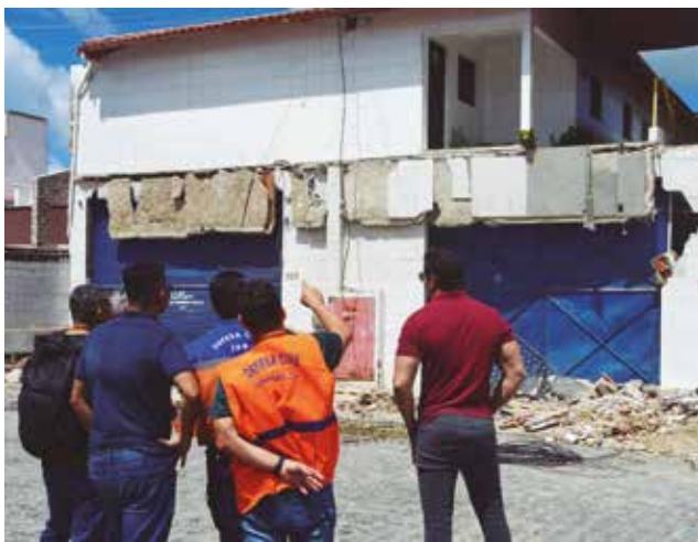
Segundo a Defesa Civil, toda a estrutura foi afetada
